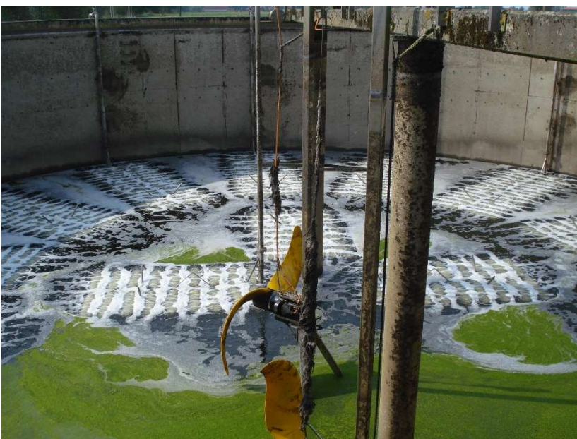
Strangentlüfter in Betrieb
