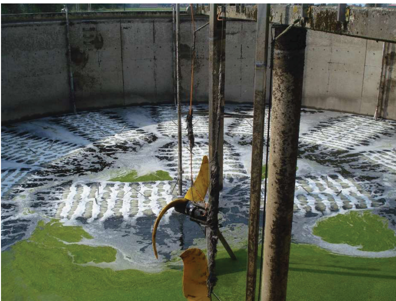
Strangentlüfter in Betrieb
